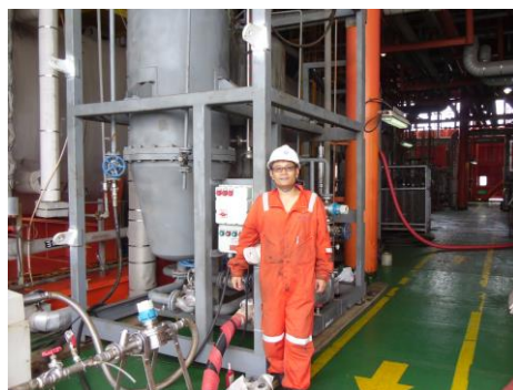
旋流气浮一体化设备在 JZ25-1 中心平台试验
